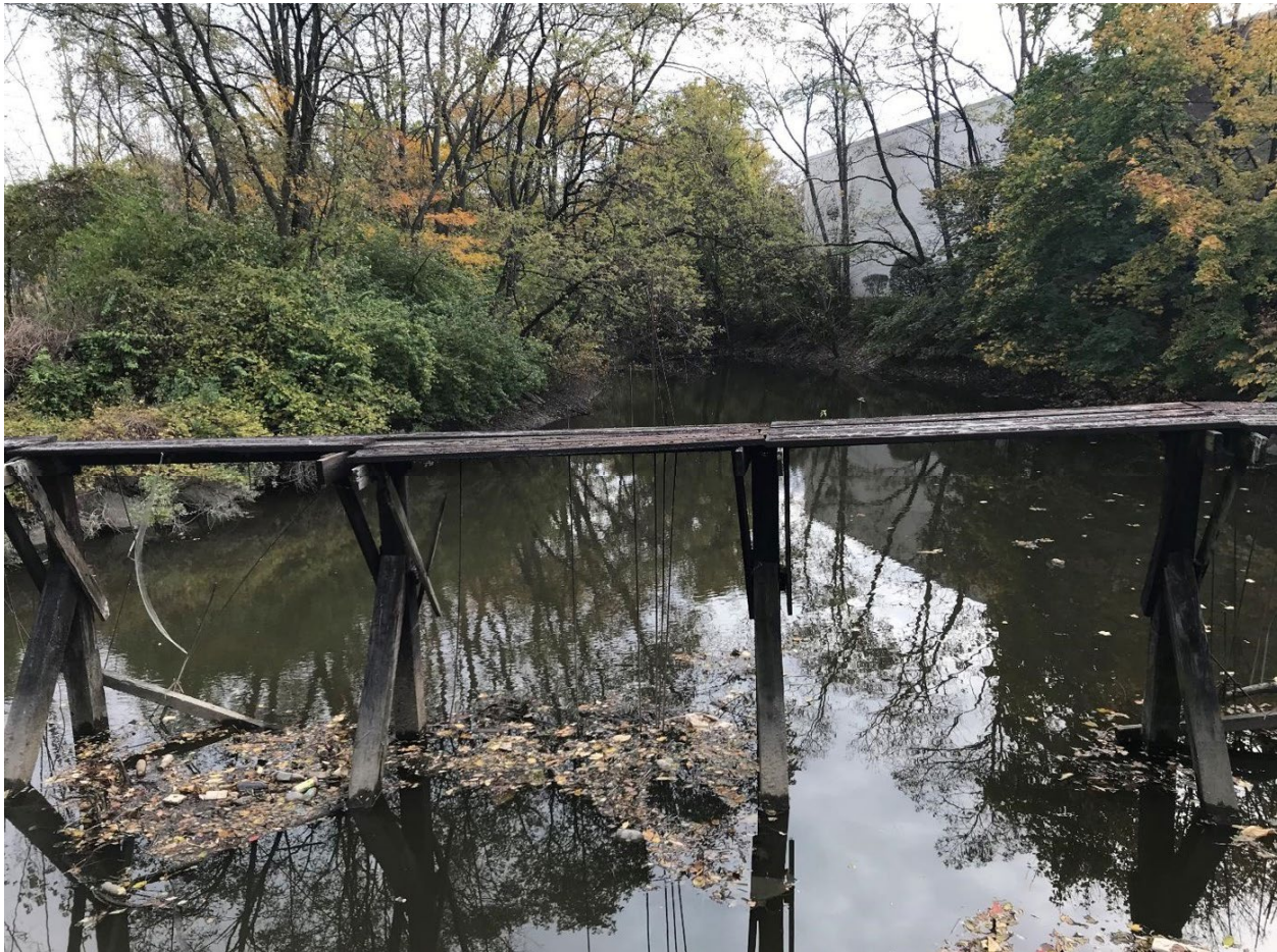
Figure 5-1. Existing Bar Screen in ER
